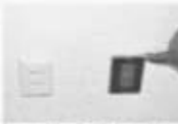
災害時に差し込む太陽光発電用コンセント（右）と通常用コンセント
