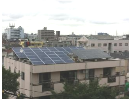
NPO法人「ほっとコミュニティえどがわ」が運営する高齢者グループホームほっと館の屋上に設置された「えど・そら2号機」。2007年に設置した市民立江戸川・第二発電所の空きスペースに建設しました。南向きで、南側には低層の都営住宅があるだけなので日当たり良好です。
