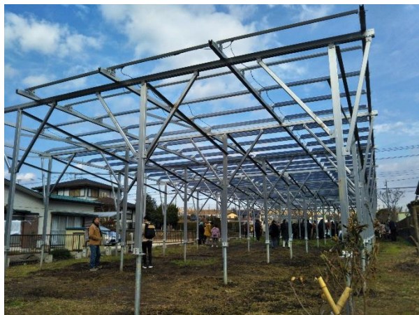
あつぎ市民発電所 第1号発電所
